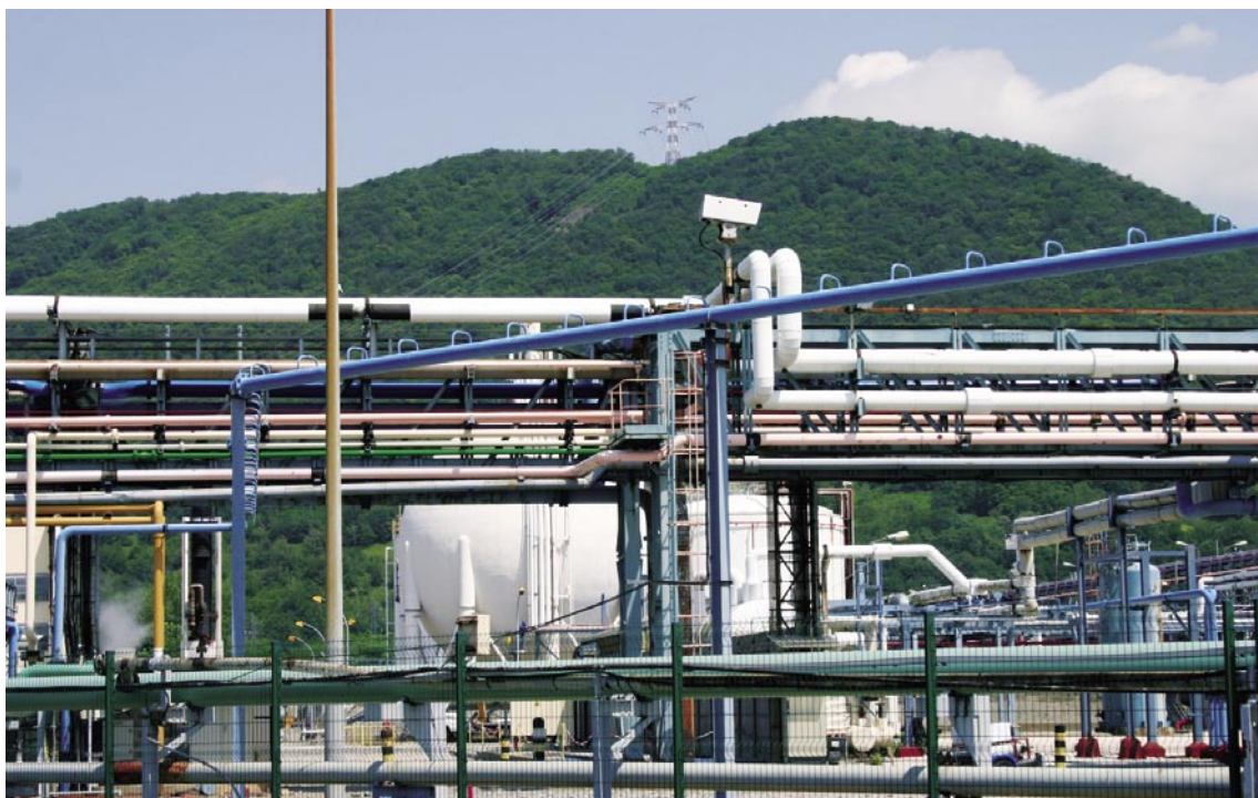
■ Canalisations aériennes au sein d'un site industriel
