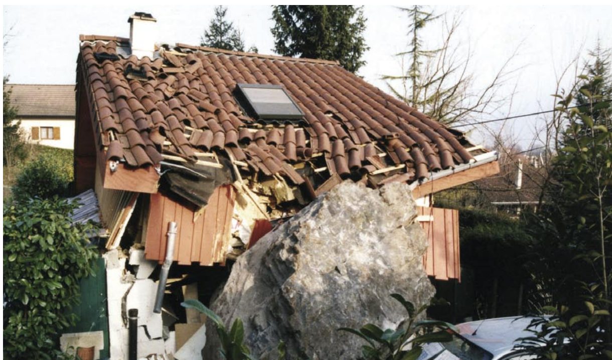
■ Habitation détruite par la chute d'un bloc de 30 tonnes depuis le versant Est du massif de la Chartreuse - Lumbin (38) - janvier 2002
